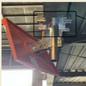
H 鋼取付ネグロス 金具+吊下げ支柱
